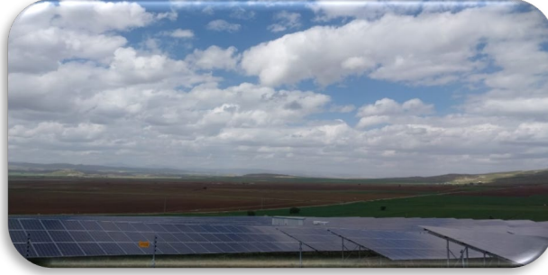
Muğla, Ankasun Çamköy 1 - 1,43 MWp
